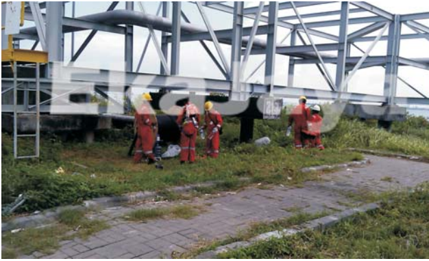
Instalasi FO dalam tray outdoor migas
