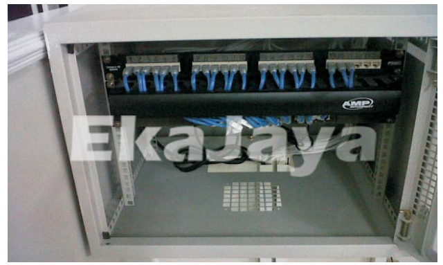
Data Cabinet Cabling pada wallmount rack
